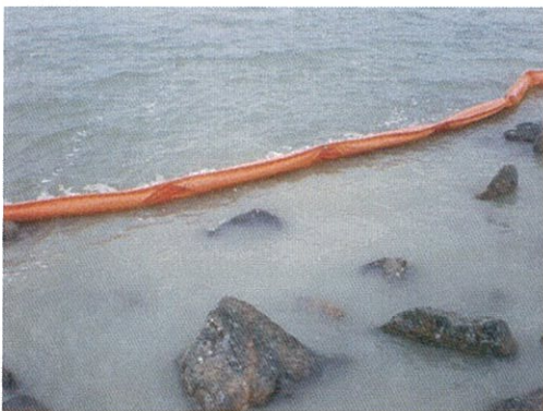
(08-28-2012)NP1 Sediment Barrier 2
