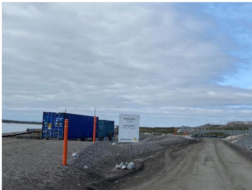
Photo 3: Saline Effluent Discharge Seacans
