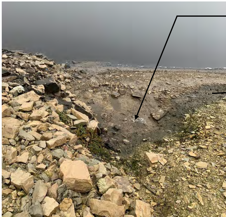
Local riprap damage
